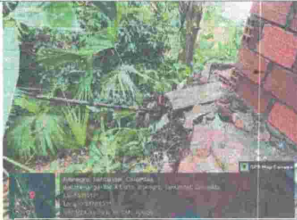
Fotografía No. 15. Borde de la vivienda y disposición de RCD.
