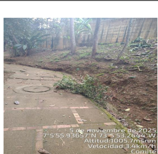
Fotografía 2. Residuos vegetales producto de poda generada por el conjunto contiguo al Parque Las Mojarras, barrio Lagos del Cacique del municipio de Bucaramanga.
